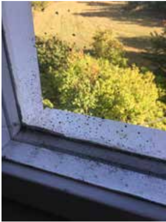
Fukt/mögelangrepp på fönstret på översta våningen
