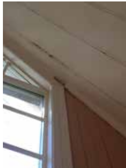
Stora rummet övervåningen: Det har rasat ner träspån från taket, se bild. Bör undersökas att det inte är husbock, trägnagare eller annat som bosatt sig i väggarna.
