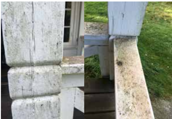
Träsnickerierna på verandan. Fukt/mögelangrepp.
